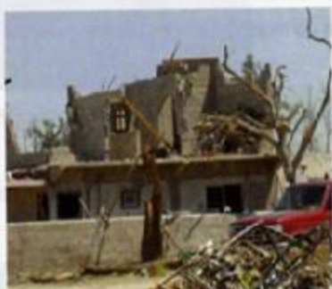
Figura 9. Daños por el tornado de Piedras Negras, 2007.
