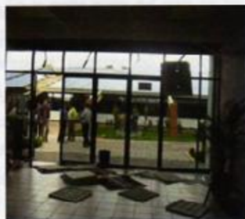
Figura 7 Daños en Rectoría de la UTT, Tlaxcala, 2004
