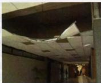
Figura 5. Daños en Rectoría de la UTT, Tlaxcala, 2004.
